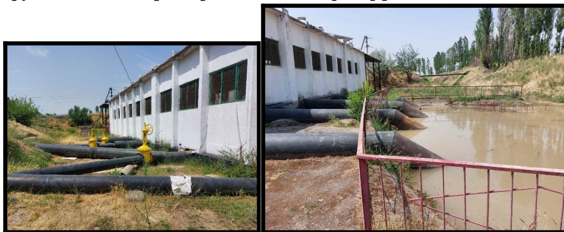
Рис.1 Оросительная насосная станция «Ангор-2», напорные и всасывающие трубопроводы
