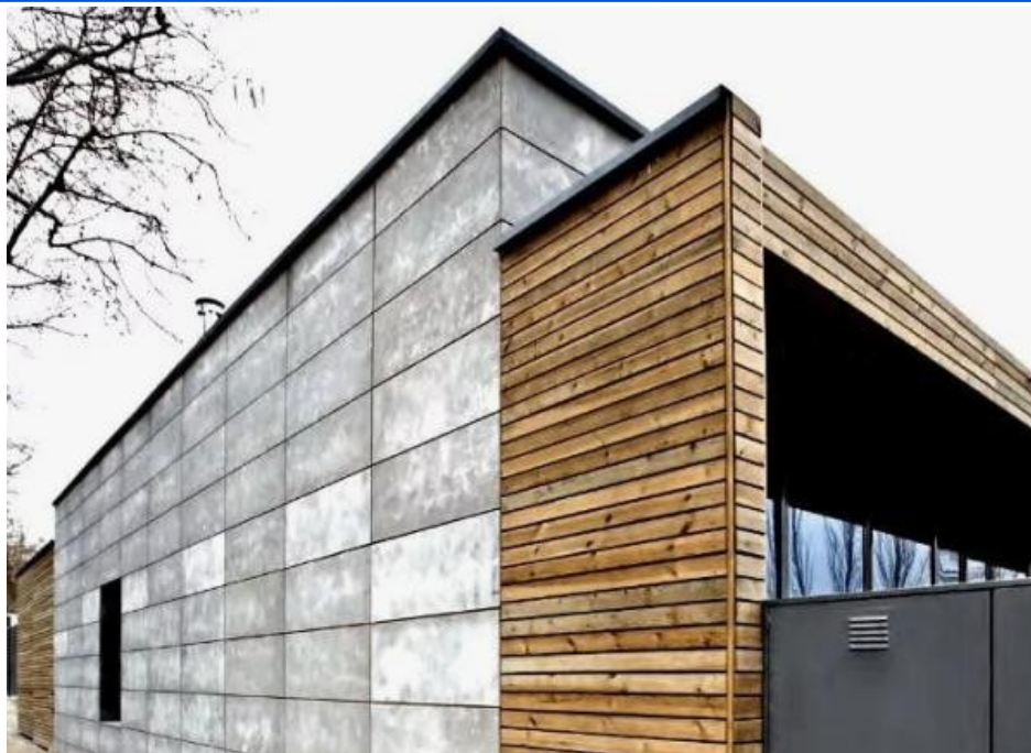
Рисунок 4. Поверхность стены после применения ЦСП
